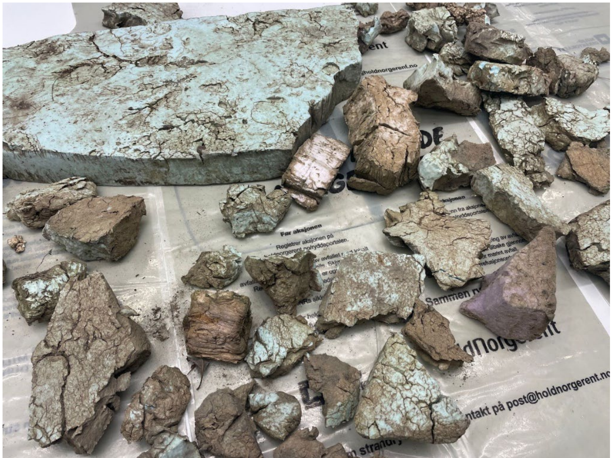
XPS-plater etter rivingsprosjekt. Platene har vært gravd ned i byggets levetid. Både blå og lilla XPS kommer fram på bildet.
