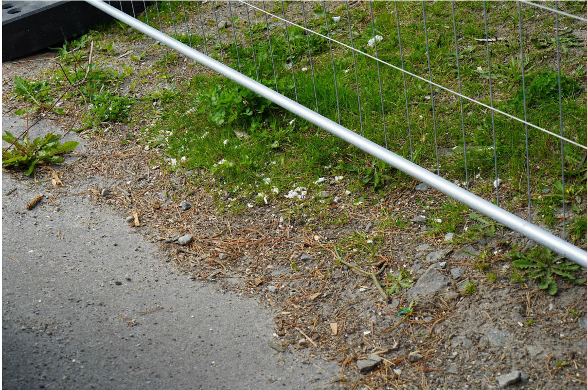
Småbiter og smuler av EPS både innenfor og utenfor gjerdet til byggeplassen.
